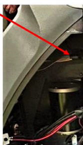
Frontpanelens jordledning (D)
